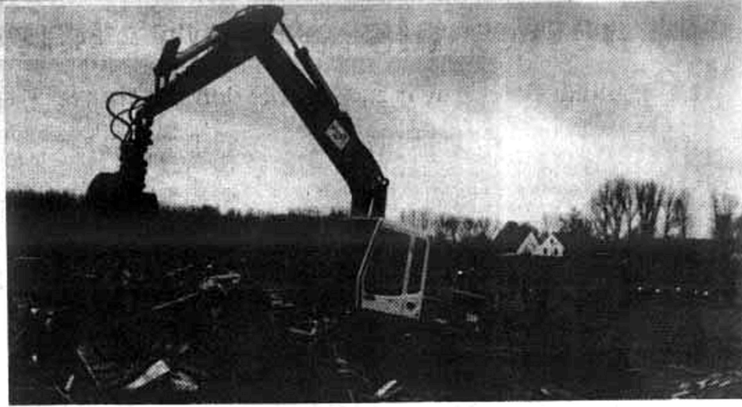
DAS WARS für das Hüttendorf: Nachdem das Gelände geräumt worden war, machte ein Bagger die Holzgebäude dem Erdboden gleich. Fotos (2): Michael Hehmann
